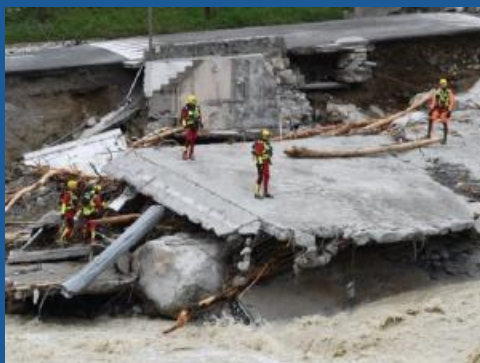
Dégâts causés par la tempête Alex, octobre 2020 © DGSCGC
